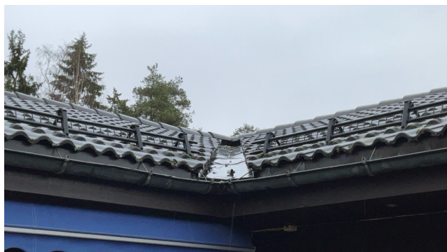
Synlig elde og avvik på gradrenner.
