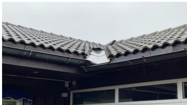
Synlig elde og avvik på gradrenner.
