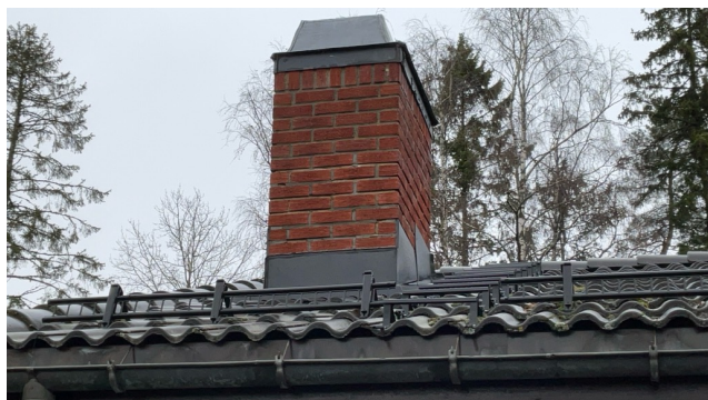
Synlig elde og avvik på beslag generelt.
