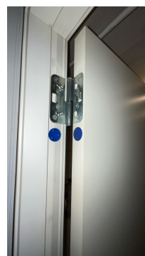
Tilfredsstillende brandndør til fyrrom er montert.
