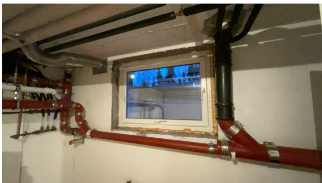
Belistning og tetting må fredigstilles.
