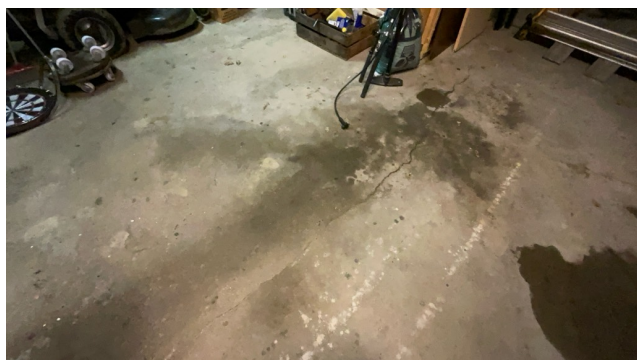
Synlig riss på betongsålen.
