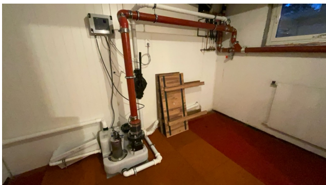
Avløpspumpe til badet i kjeller.
