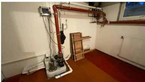
Avløpspumpe til badet i kjeller.
