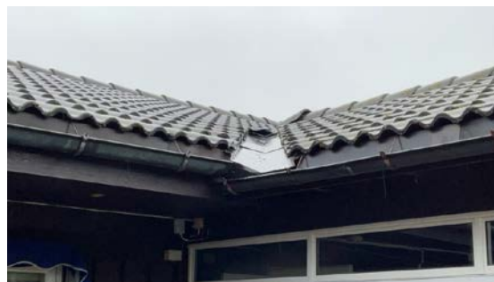
Synlig elde og avvik på gradrenner.
