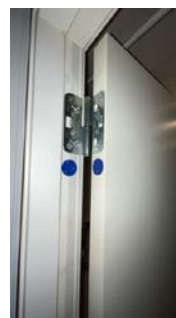
Tilfredsstillende brannrør til fyrrom er montert.
