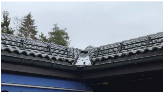
Synlig elde og avvik på gradrenner.
