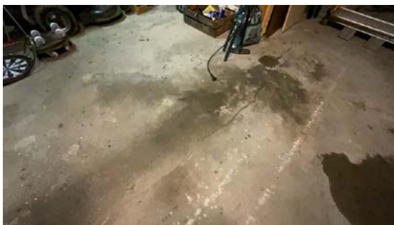
Synlig riss på betongsålen.
