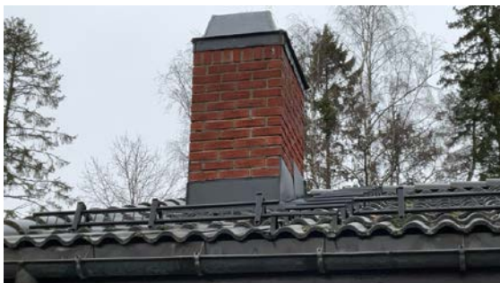
Synlig elde og avvik på beslag generelt.
