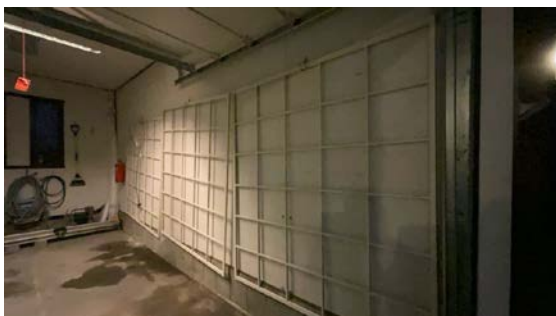
Synlige asbestplater på overflater.
