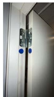
Tilfredsstillende brannrør til fyrrom er montert.
