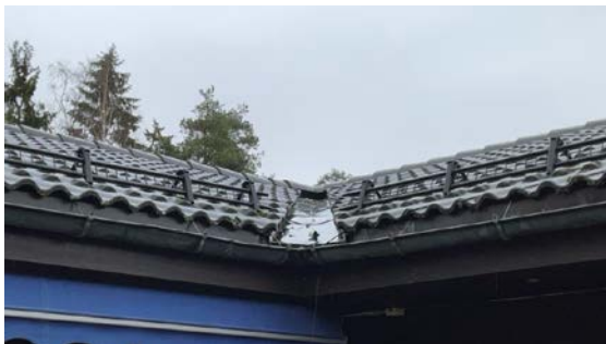
Synlig elde og avvik på gradrenner.
