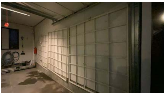
Synlige asbestplater på overflater.
