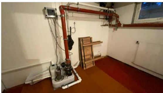
Avløpspumpe til badet i kjeller.
