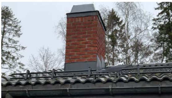
Synlig elde og avvik på beslag generelt.
