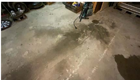
Synlig riss på betongsålen.
