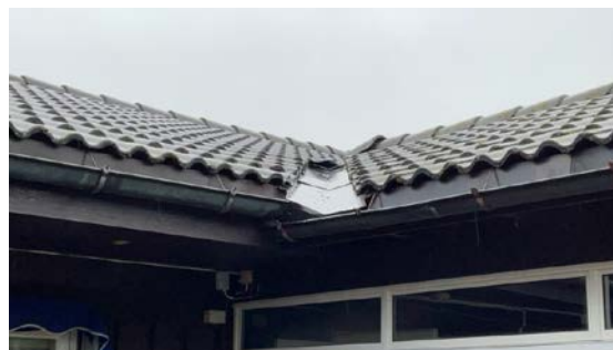
Synlig elde og avvik på gradrenner.
