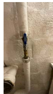
Besiktigelse av røropplegg. Stoppekran fra Biltema bør trolig byttes på sikt.
