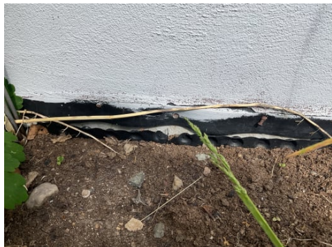
Glippe mellom grunnmursplast og topplist.
