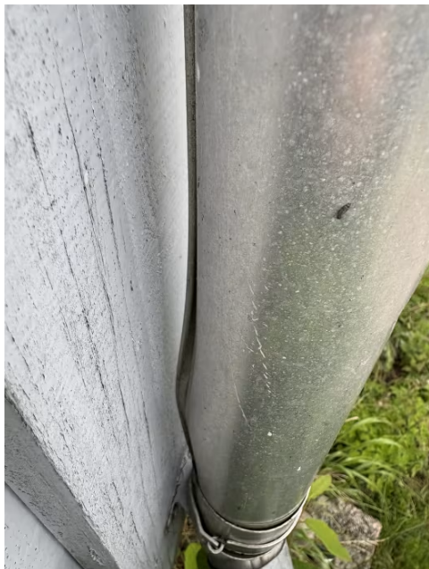
Frostsprengh i nedløpsrør.
