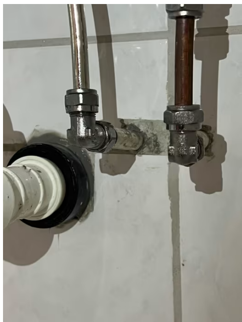
Rørgjennomføringer tettet med silikon.
