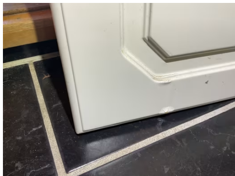
Vannskade på innredning.
