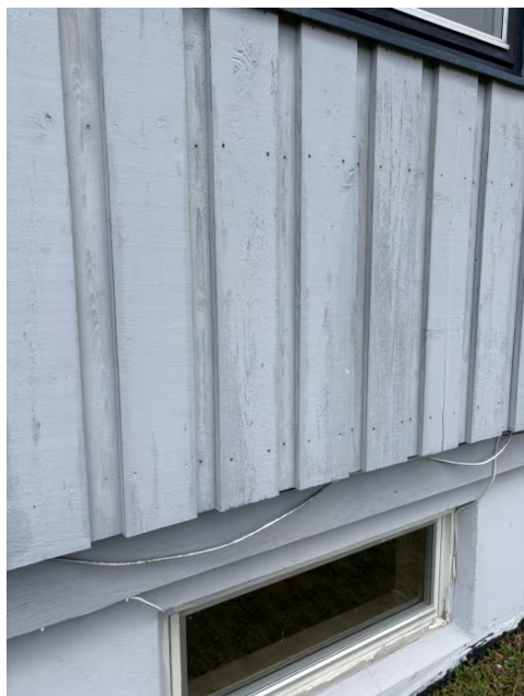
Svertesopp på utvendig kledning.
