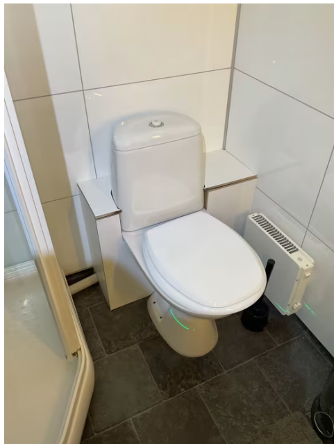
Wc. innebygget kvern til wc og dusj.
