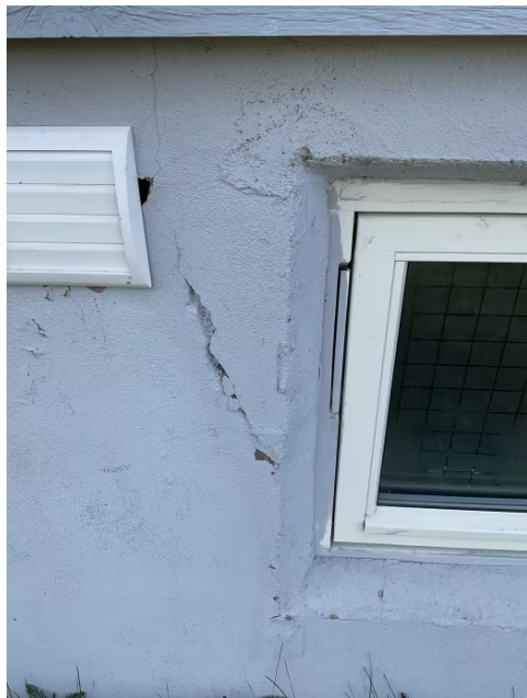
Sprekker i grunnmur.
