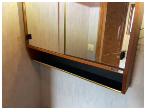
Sprekk i speil over servant.
