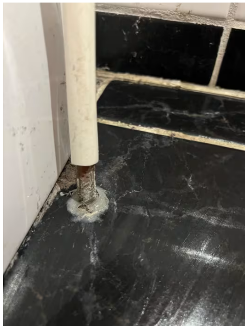
Rørgjennomføringer tettet med silikon.
