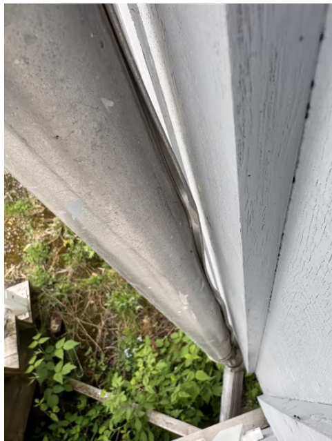
Frostspreng i nedløpsrør.
