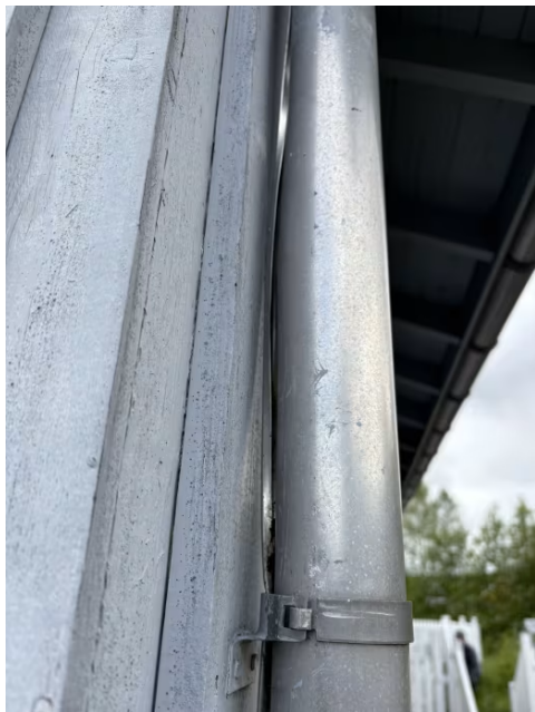
Frostsprengh i nedløpsrør.
