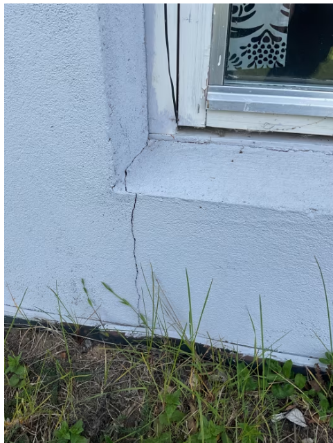
Sprekker i grunnmur.
