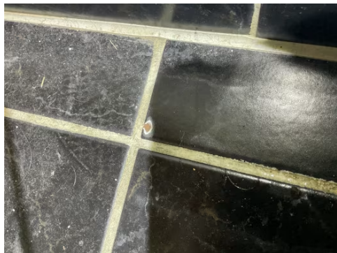
Avskalling på gulvflis.
