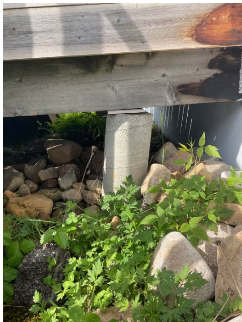
Skjevheter i fundamentering.
