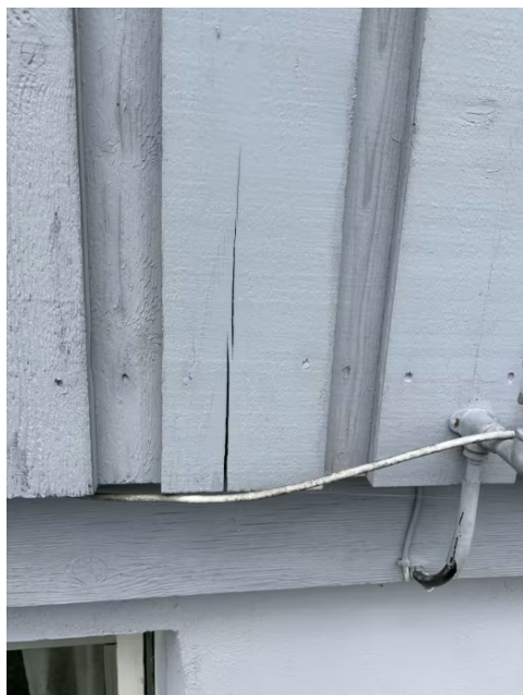
Sprekker i kledning.
