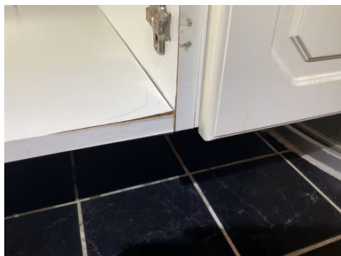
Vannskade på innredning.
