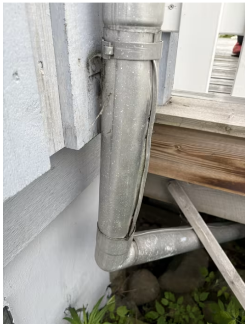
Frostspreng i nedløpsrør.
