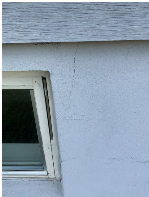
Sprekker i grunnmur.
