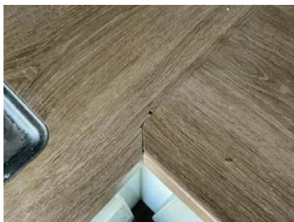
Unormal slitasje på overflater.
