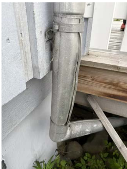
Frostsprengh i nedløpsrør.
