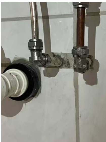
Rørgjennomføringer tettet med silikon.
