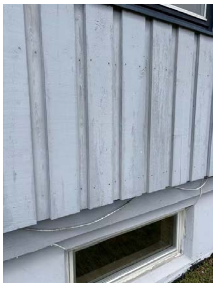
Svertesopp på utvendig kledning.
