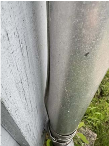
Frostspreg i nedløpsrør.
