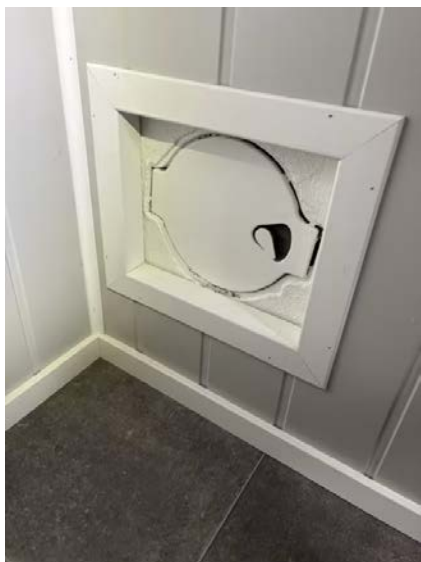
Sotluke i kjeller.
