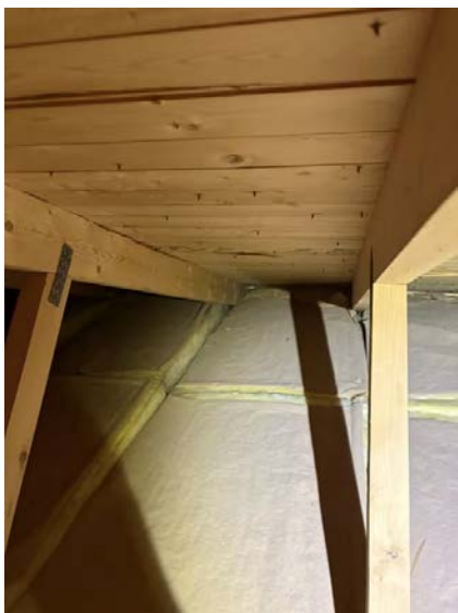
Redusert lufting i raftet.
