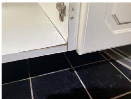
Vannskade på innredning.
