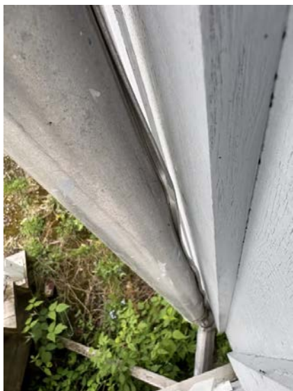
Frostsprengh i nedløpsrør.
