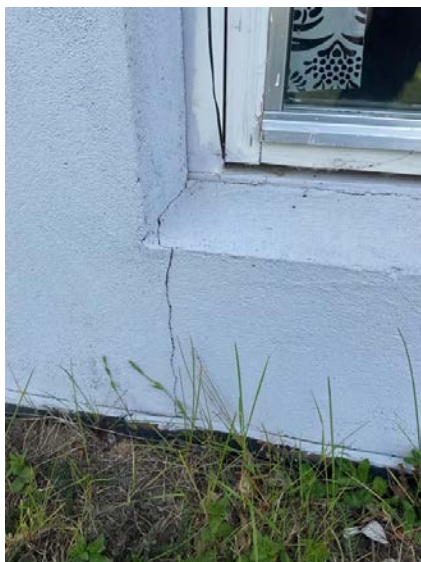
Sprekker i grunnmur.
