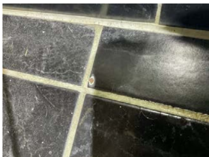
Avskalling på gulvflis.
