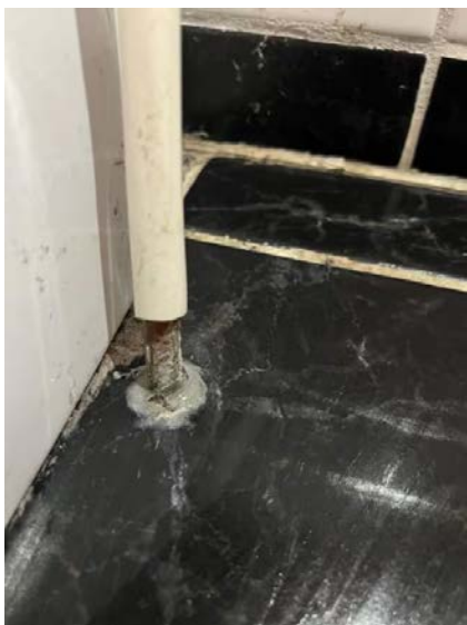
Rørgjennomføringer tettet med silikon.
