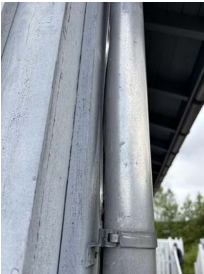
Frostspreg i nedløpsrør.
