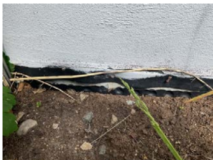
Glippe mellom grunnmursplast og topplist.
