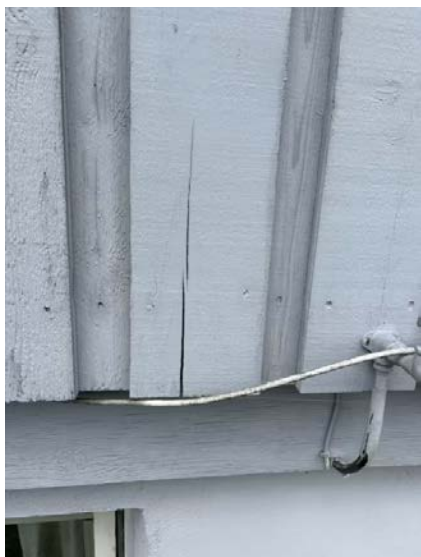
Sprekker i kledning.
