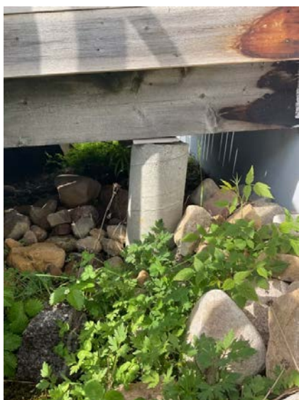
Skjevheter i fundamentering.
