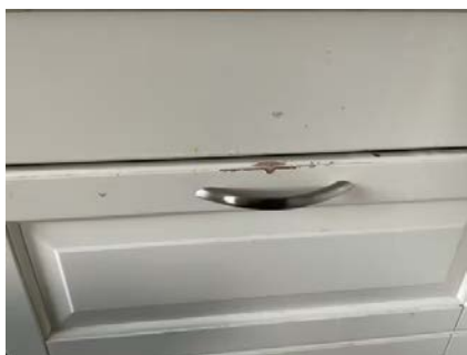
Unormal slitasje på overflater.
