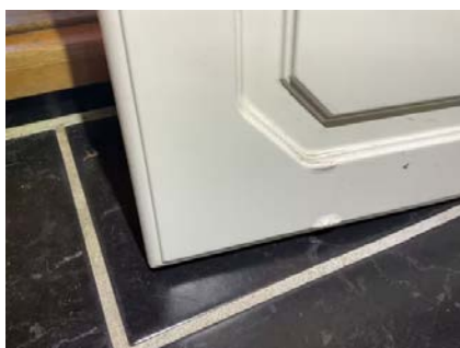
Vannskade på innredning.
