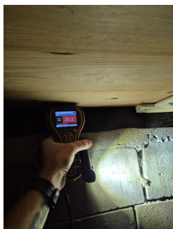
Målt høye fuktverdier i treverk.
