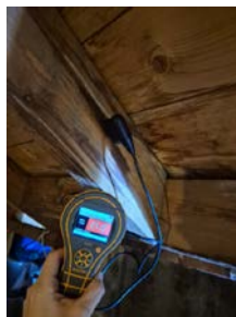
Målt fukt i området rundt pipe.
