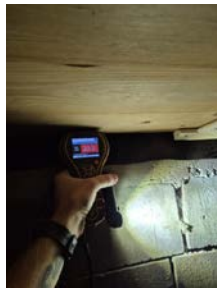
Målt høye fuktverdier i treverk.
