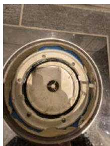
Sluk på gulv har ikke synlig membran under hele klemring - kun delvis.
