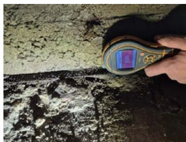
Råte i treverk i bunn og indikert fukt i mur.
