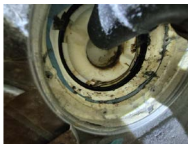
Sluk under kabinett har synlig membran under hele klemring.
