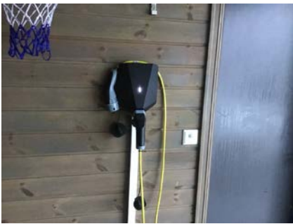
Elbil lader i garasje
