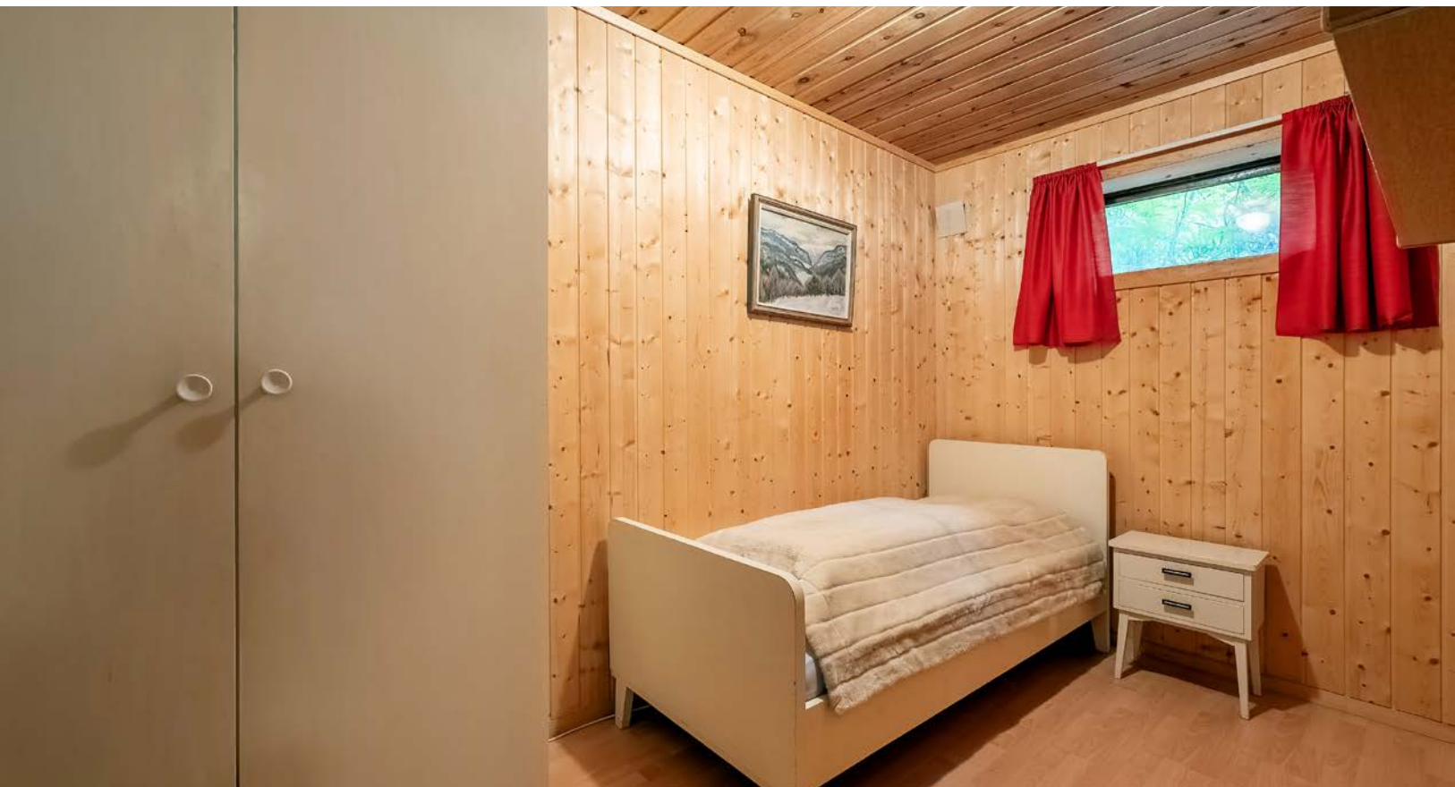
Rom innredet og benyttet som soverom (angitt som "disp." på tegninger og "bod" i salgsoppgave) er ikke omsøkt og godkjent for varig opphold
