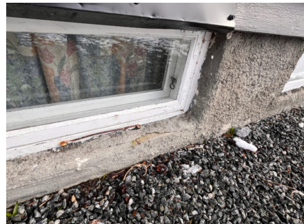
Mangler beslag under vindu
