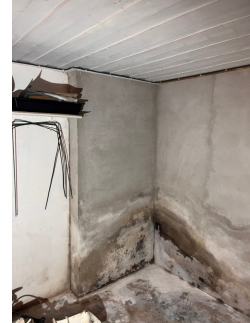
Synlig fukt på innside av grunnmur i hjørne mot nordøst
