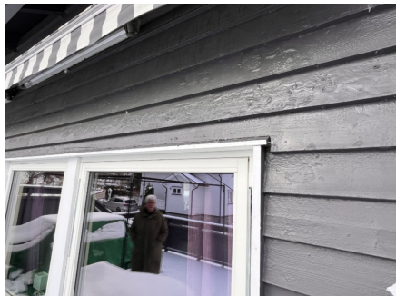
Ikke spalte mellom vannbrett og kledning
