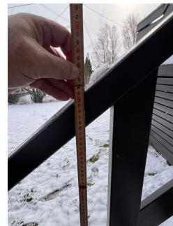
Trapp til altan, høyde på rekkverk under 90 cm
