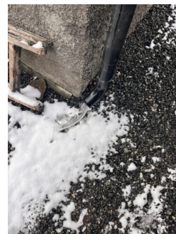
Hjørne nordøst, svak løsning med vannutkast like inntil grunnmur og ikke tilfredsstillende fuksikring på muren.
