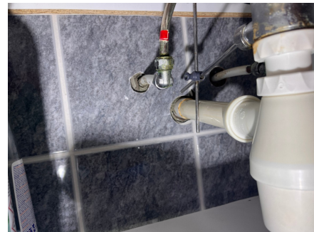
Ikke fuget rundt rør i vegg
