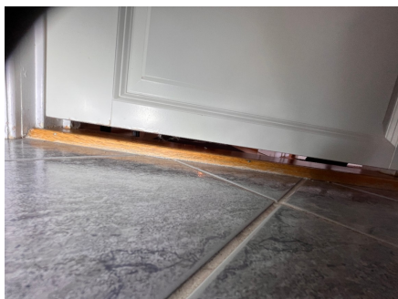
Liten oppkant under dør.
