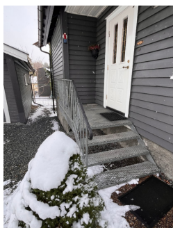
Trapp til hovedinngang, store åpninger i rekkverket
