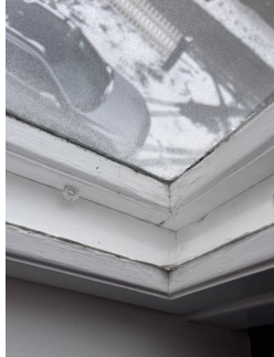
Merker etter kondensvann, koblet vindu på loft.
