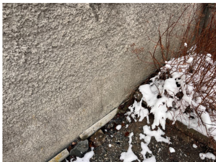
Langs østvegg synlige eternittplater.
