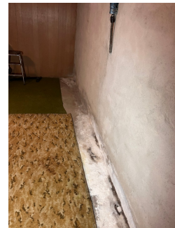
Synlig fukt på innside av grunnmur mot nord
