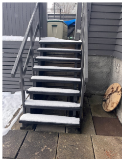
Trapp til altan, store åpninger i rekkverket
