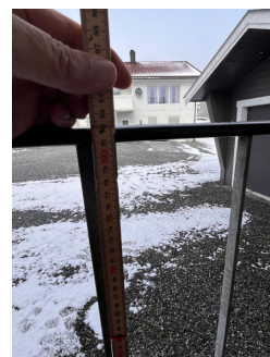
Trapp hovedinngang, høyde på rekkverk under 90 cm
