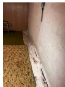
Synlig fukt på innside av grunnmur mot nord
