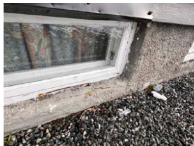
Mangler beslag under vindu
