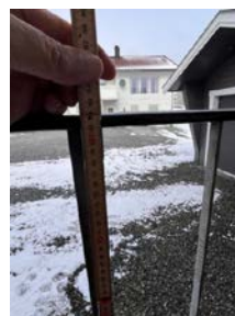
Trapp hovedinngang, høyde på rekkverk under 90 cm
