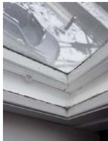
Merker etter kondensvann, koblet vindu på loft.
