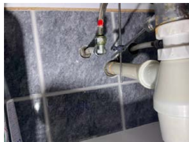
Ikke fuget rundt rør i vegg
