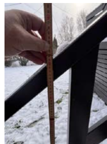
Trapp til altan, høyde på rekkverk under 90 cm
