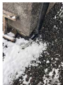
Hjørne nordøst, svak løsning med vannutkast like inntil grunnmur og ikke tilfredsstillende fuktsikring på muren.
