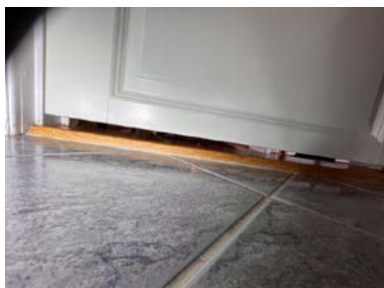
Liten oppkant under dør.
