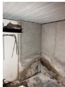
Synlig fukt på innside av grunnmur i hjørne mot nordøst
