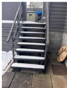
Trapp til altan, store åpninger i rekkverket
