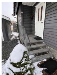
Trapp til hovedinngang, store åpninger i rekkverket
