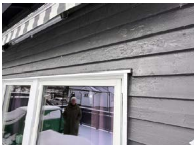
Ikke spalte mellom vannbrett og kledning
