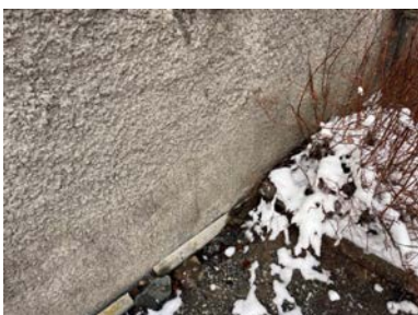
Langs østvegg synlige eternittplater.
