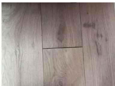
Åpninger i skjøter på laminat i stue
