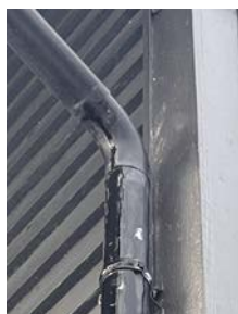
Bend på nedløp er montert feil, vann renner ut i skjøter.
