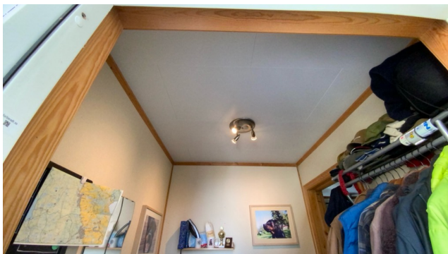
Ingen tilgang til takkonstruksjon.
