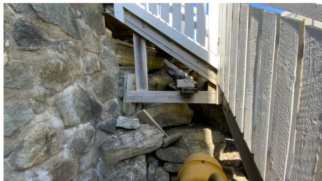
Lokale utbedringer er påregnelig.
