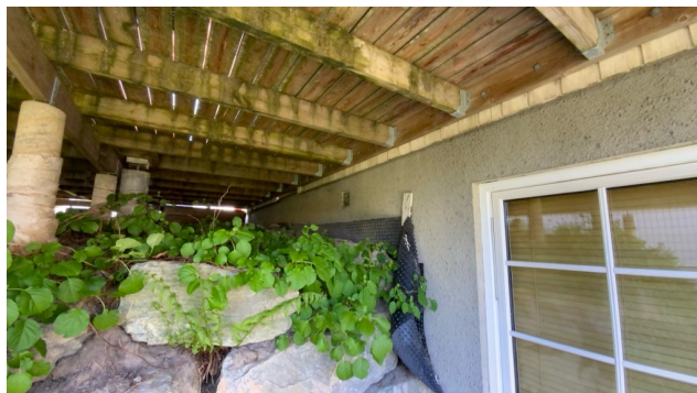
Kontroll av drenering/fuktsikring. Klemplis på topp av fuktsikring mangler og bør utbedres.
