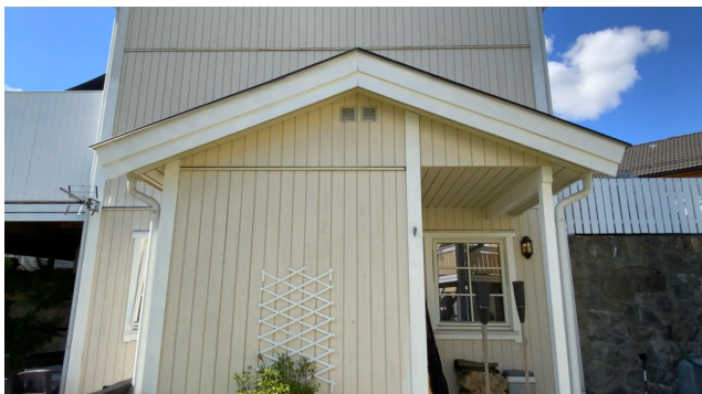
Ingen tilgang til takkonstruksjon.
