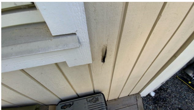
Skadet panelbord bør byttes.
