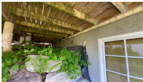
Kontroll av drenering/fuktsikring. Klemlist på topp av fuktsikring mangler og bør utbedres.
