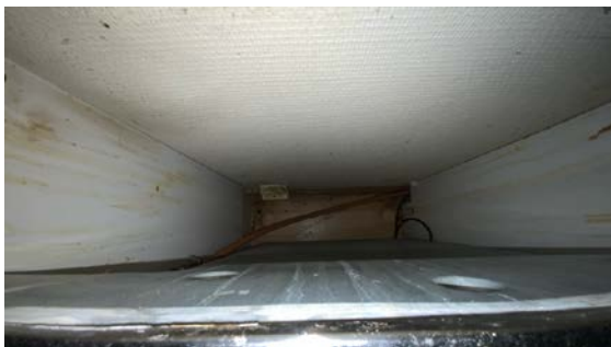
Noe synlig elde på baksiden av ovn.
