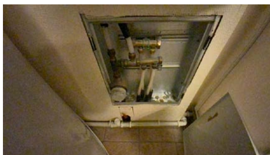
Avrenning ut av fordelerskap mangler og bør opparbeides.
