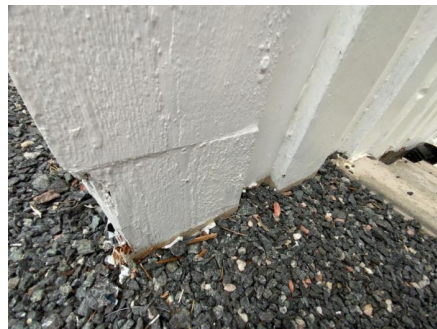
Synlig råte i panel som ligger under tereng ved betongtrapp.
