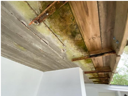
Synlig åpen rusten armering i betongen.
