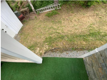
Åpning i rekkverk på balkongen må utberes med tanke på sikkerhet.
