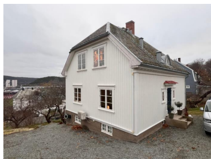
Vann vil renne inn mot grunnmur ved trappen.
