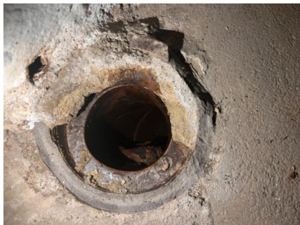
Rør som ikke er i bruk kommer opp av gulvet
