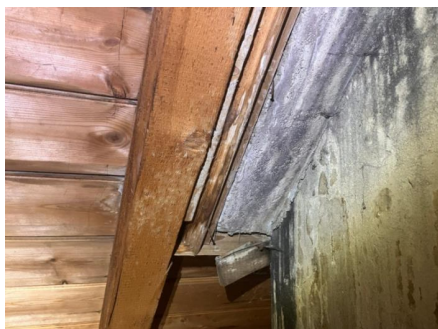
Eldre fuktmerker ved pipe.
