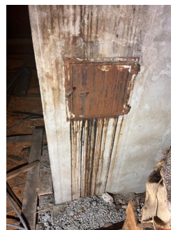
Feieluke på loft, kan ikke brukes lengre på grunn av nytt røykrør.
