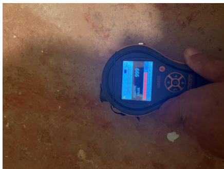
Målt på gulv i toalettrom viser høyt fuktnivå
