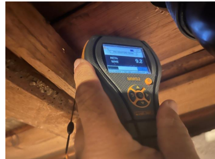
I himling i kjeller ved slukrenne.
