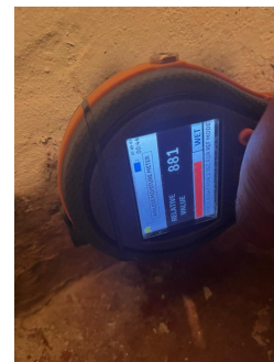
Målt på vegg på toalettrom viser høyt fuktnivå
