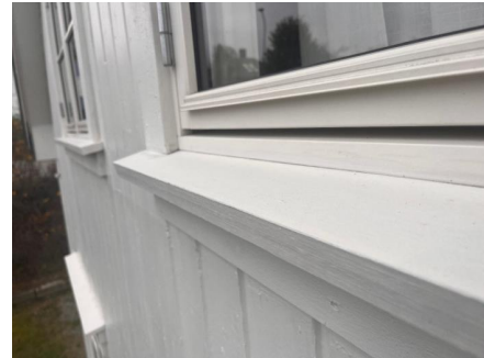
Mangler spalte mot vannbrett
