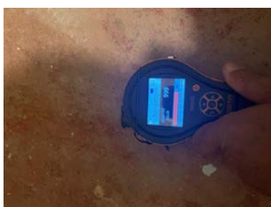
Målt på gulv i toalettrom viser høyt fuktinnivå
