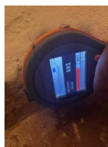
Målt på vegg på toalettrom viser høyt fuktinnivå
