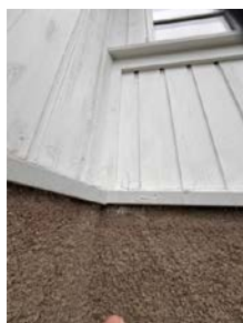
Noe sprekker i kledningen og ikke lufting
