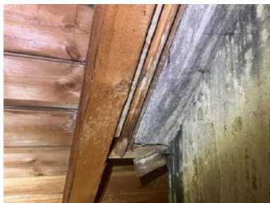
Eldre fuktmerker ved pipe.
