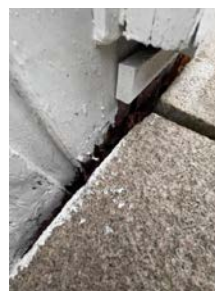
Kledning bak trapp kan ha skader
