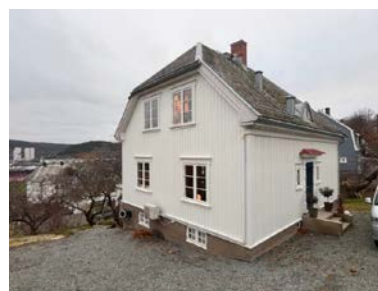
Vann vil renne inn mot grunnmur ved trappen.
