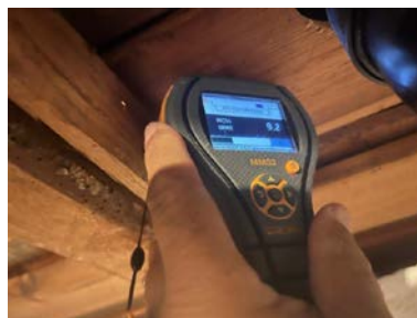
I himling i kjeller ved slukrenne.
