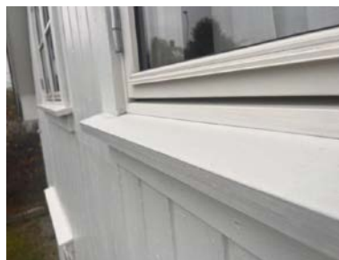
Mangler spalte mot vannbrett
