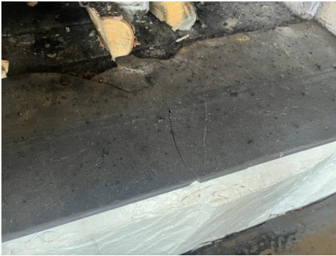
Sprekk i flis ved peis
