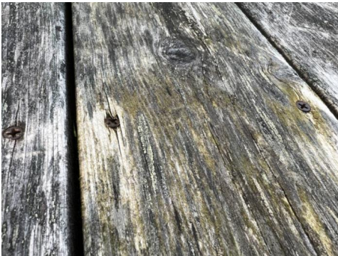
Synlig rust på skrue
