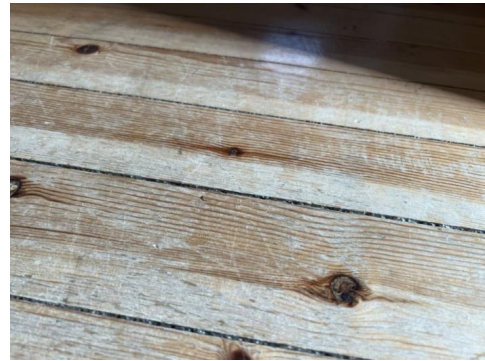
Slitasje på gulvoverflate
