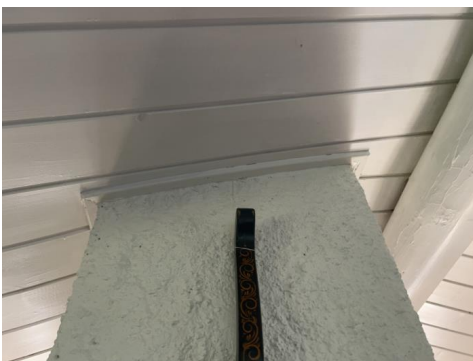
Manglende utkraging og avstand til brennbart materiale blir da for kort
