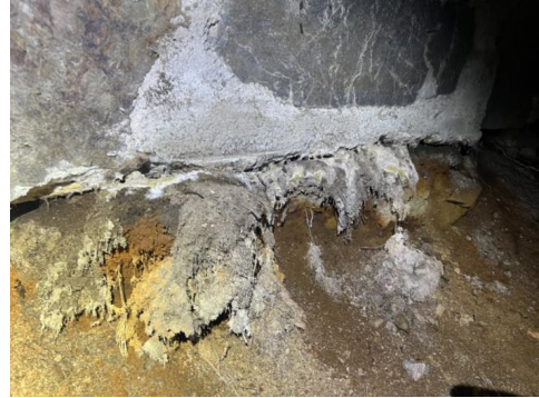
Utsig under deler av opprinnelig mur med synlig muggsopp på grunn
