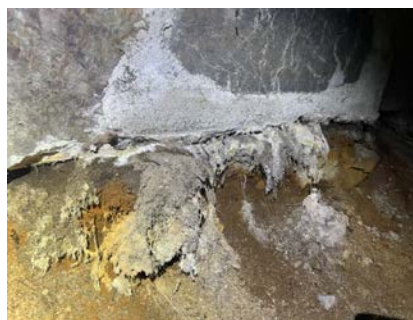
Utsig under deler av opprinnelig mur med synlig muggsopp på grunn
