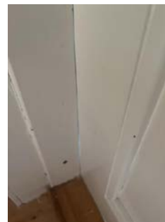
Utettheter i overgang dørblad/karm og anbefaler tettpakning
