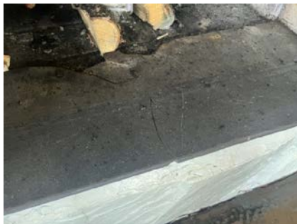
Sprekk i flis ved peis
