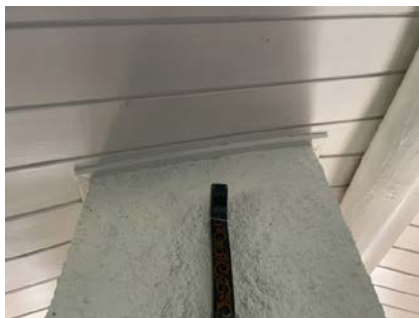
Manglende utkraging og avstand til brennbart materiale blir da for kort
