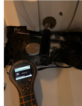
Fuktmåling i vegg mot våtsone
