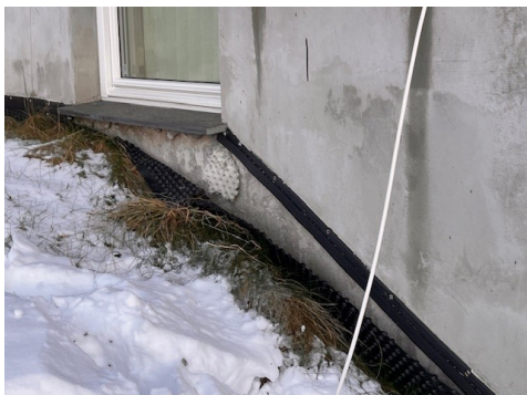
Fuktsperre på grunnmur er løsnet.
