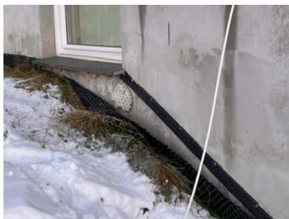
Fuktsperre på grunnmur er løsnet.
