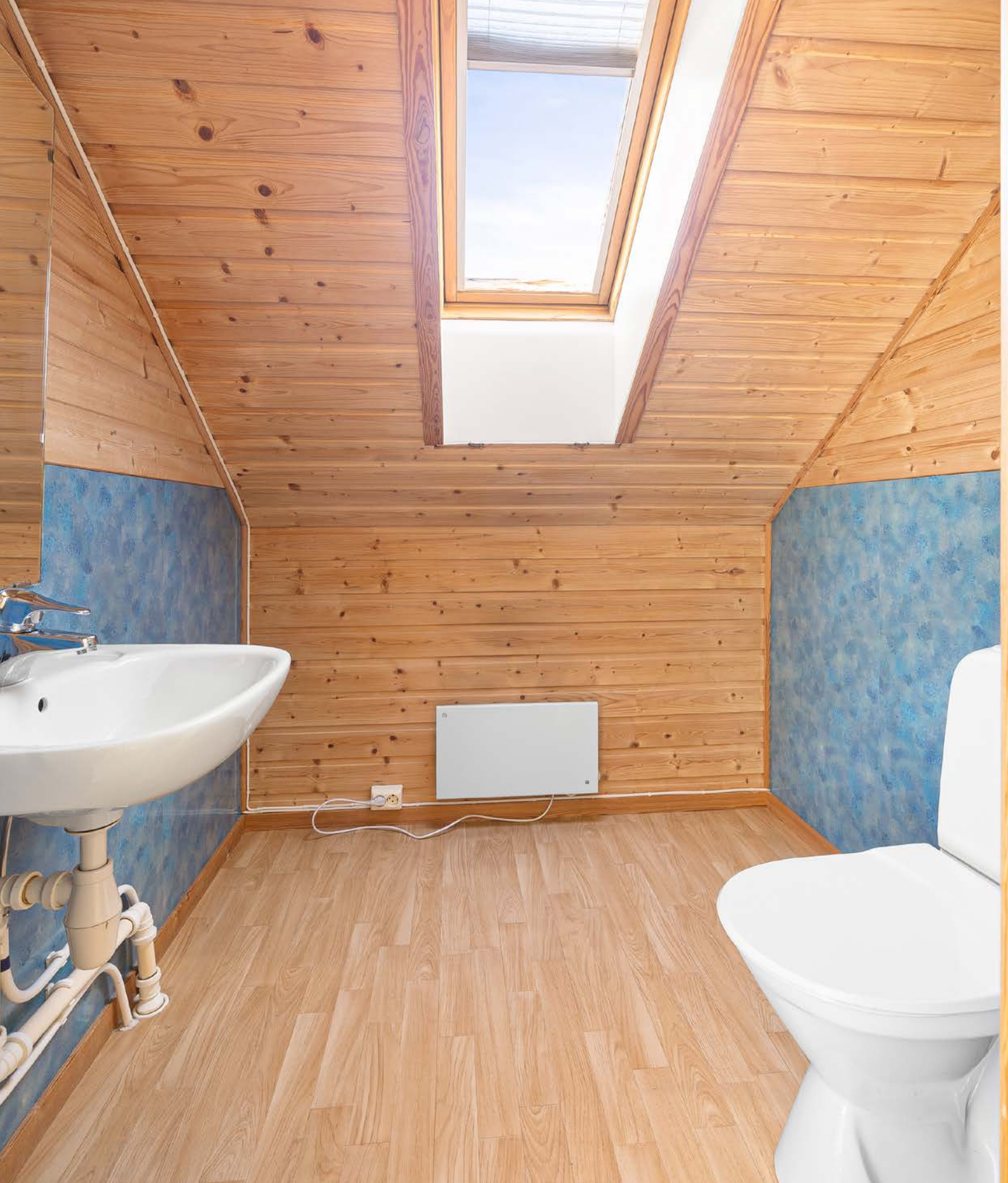
Rommet er innredet med servant, speilskap og toalett.
