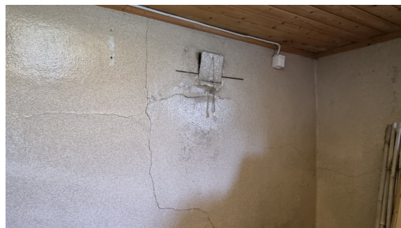
Sprekker i grunnmur/kjelleryttervegg mot nordøst.
