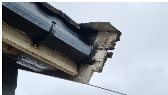
Råteskader i vindskibord.
