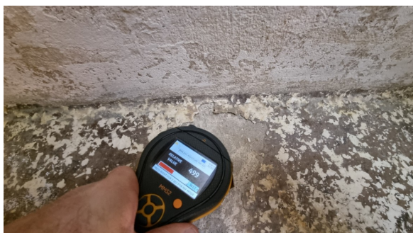
Fuktmåling i gulv i kjelleretasjen, forhøyde fuktverdier ble registrert.
