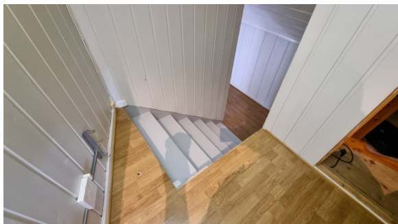
Manglende rekkverk i loftsetasjen.
