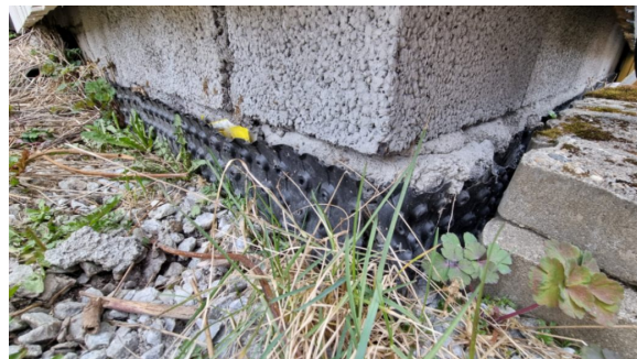
Grunnmurer er ikke utvendig pusset. Synlig grunnmursplast her er lagt feil vei.
