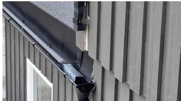
Nedløp er ikke tilfredsstillende til renne.
