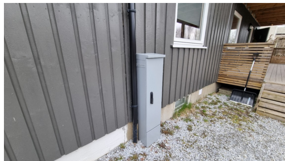
Måler for utleiedel er plassert i utvendig skap.
