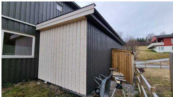
Bakveggen mangler overflatebehandling
