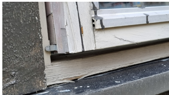
Vinduer av eldre dato har svekkelser.
