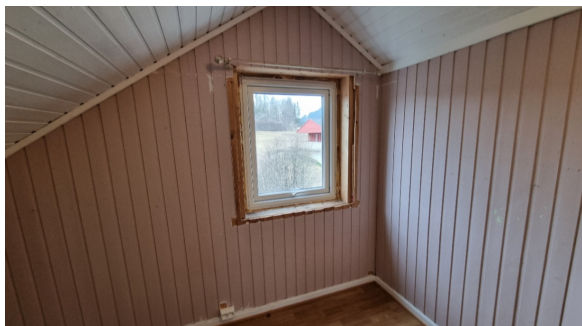
Manglende utforing og listverk på vindu av nyere dato i loftsetasjen.
