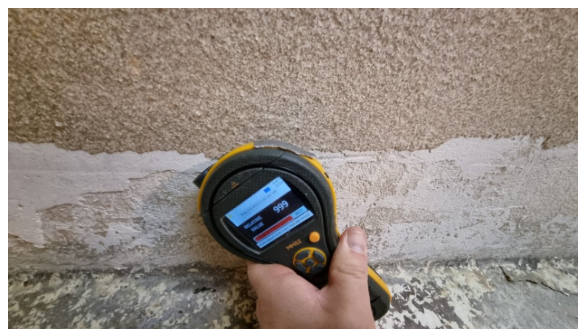
Fuktmåling i vegger i kjelleretasjen, forhøyde fuktverdier ble registrert.
