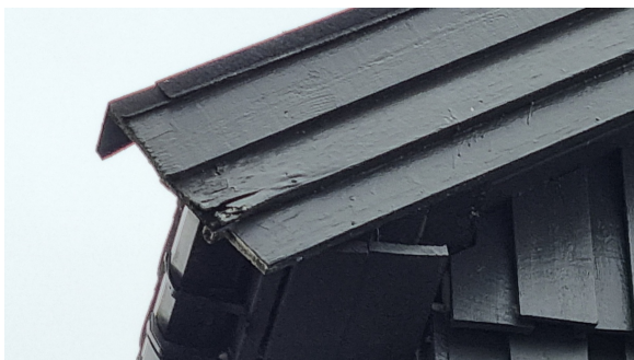
Råteskader i vindskibord.
