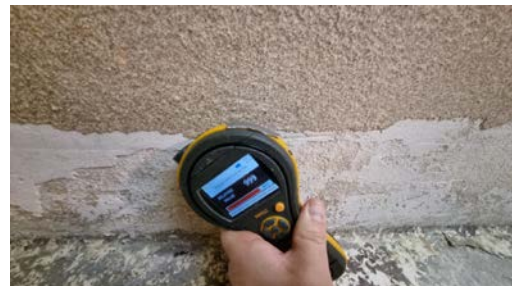
Fuktmåling i vegg i kjelleretasjen, forhøyde fuktverdier ble registrert.
