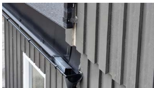
Nedløp er ikke tilfredsstillende til renne.
