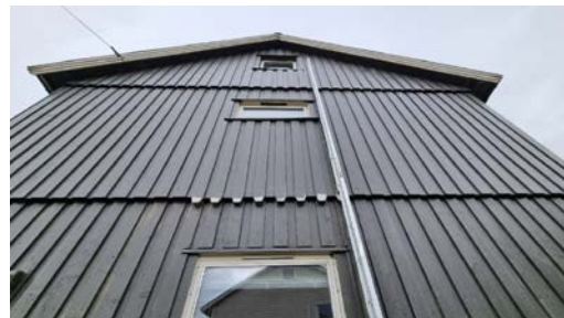
Deler av kledning på fasade sørøst er ikke ferdigkappet
