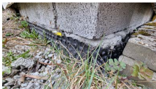
Grunnmur er ikke utvendig pusset. Synlig grunnmursplatt her er lagt feil vei.
