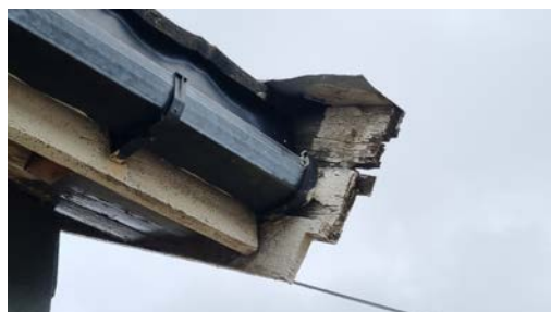
Råteskader i vindskibord.
