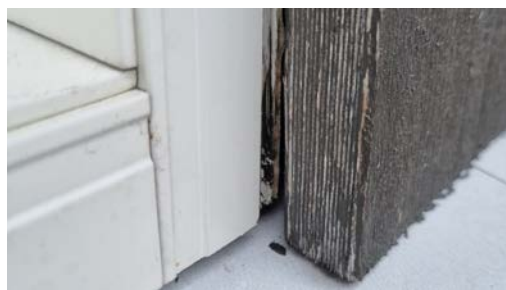
Utettheter i overgang vindu og utvendig omramming ved stuevinduer i 2. etasje.
