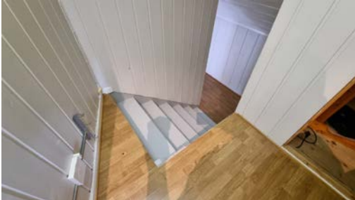
Manglende rekkverk i loftsetasjen.
