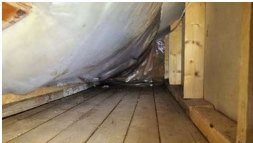
Bilde fra knekott. Stedvis tegn til misfarging på synlig isolasjon.
