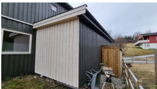
Bakveggen mangler overflatebehandling
