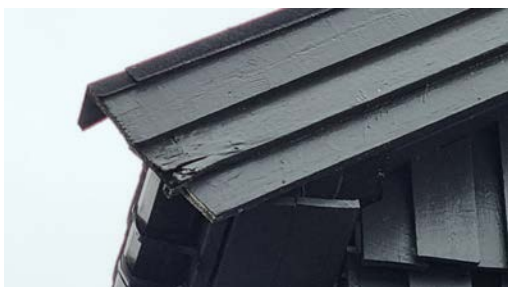
Råteskader i vindskibord.
