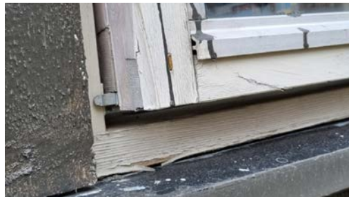
Vinduer av eldre dato har svekkelser.
