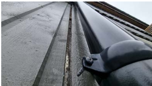
Glippe/utettheter i overgang opprinnelige del og tilbygget del.
