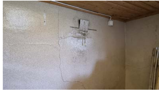
Sprekker i grunnmur/kjelleryttervegg mot nordøst.
