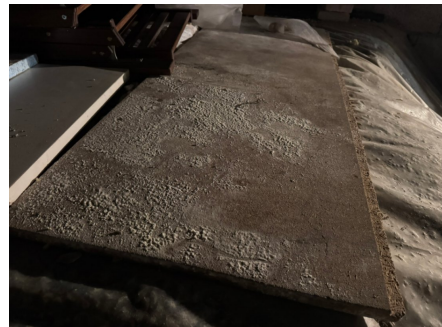
Fuktskader på lagrede materialer.
