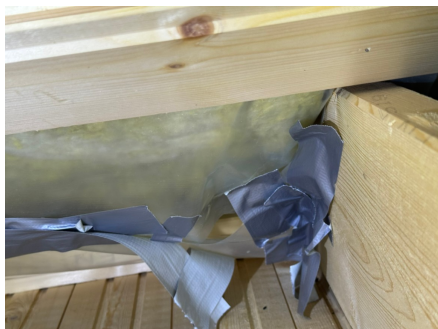
Eksempel på utettheter på dampperren.
