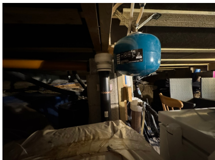
Vakuumventil i krypkjelleren.
