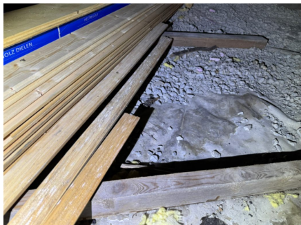
Fuktskader på lagrede materialer.
