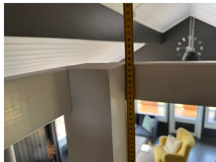
Rekkverkshøyden på hems.
