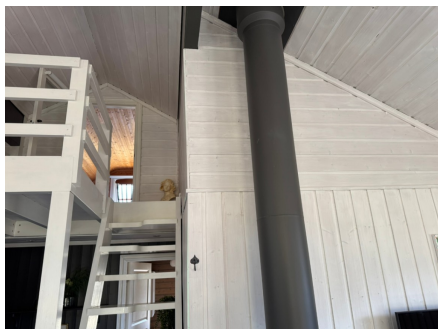
Skjevheter i delevegg.
