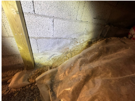
Saltutslag i krypekjelleren.
