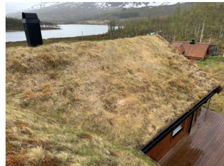
Det er ikke snøfangere på taket.
