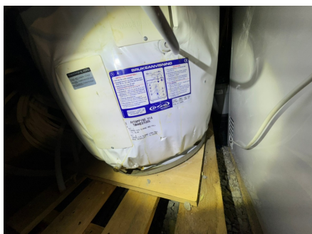
Produksjonsdato på varmtvannstanken.
