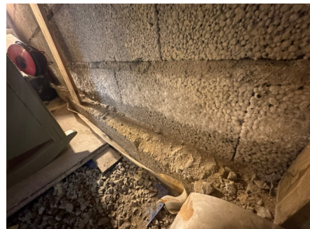
Tegn til fuktighet på grunnmuren.
