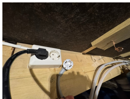
Eltilkobling av varmtvannstanken.
