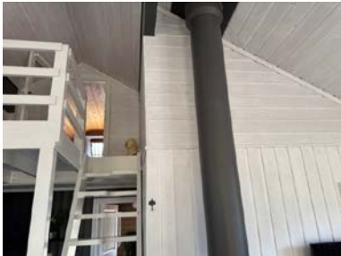
Skjevheter i delevegg.
