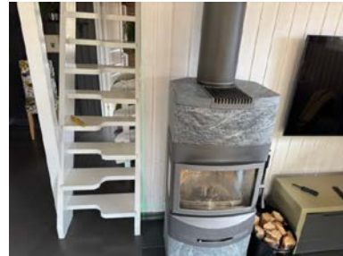
Skjevheter i delevegg.
