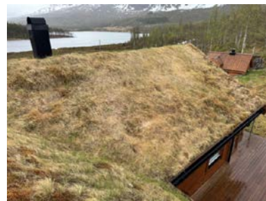
Det er ikke snøfangere på taket.
