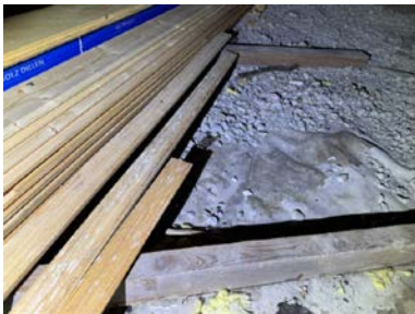
Fuktskader på lagrede materialer.
