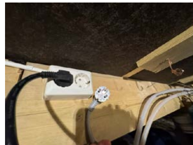
Eltilkobling av varmtvannstanken.
