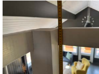
Rekkverkshøyden på hems.
