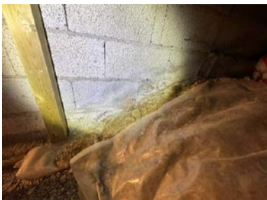
Saltutslag i krypekjelleren.
