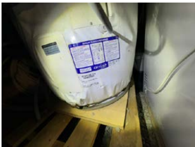
Produksjonsdato på varmtvannstanken.
