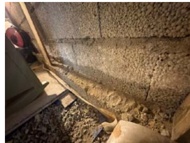
Tegn til fuktighet på grunnmuren.
