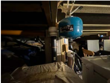
Vakumventil i krypkjelleren.
