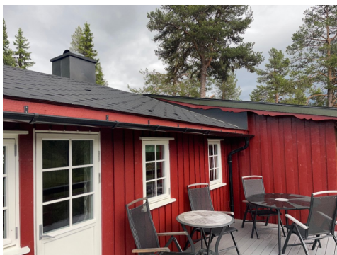
Takkonstruksjon har synlige skeivheter
