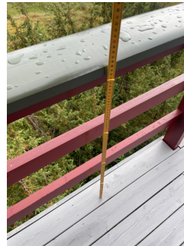
Rekkverk er for lavt jmf. regelverk for byggeår.
