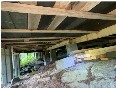
Terreng har fall mot fundamenter.
