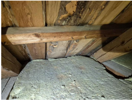
Ikke luft i nedre del av konstruksjon.
