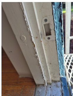
Slitte tettelister på terrassedør mot garasje.
