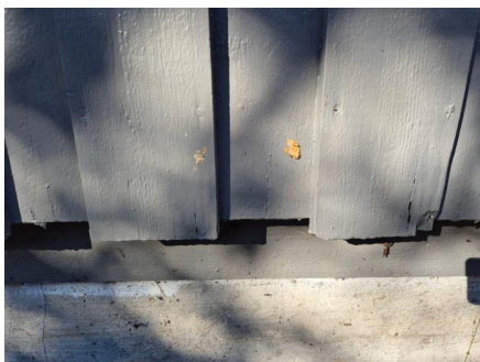
Råte i bunn av kledningsbord.
