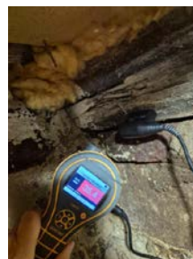
Målt høye fuktverdier i trebjelke.
