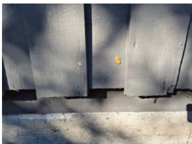
Råte i bunn av kledningsbord.
