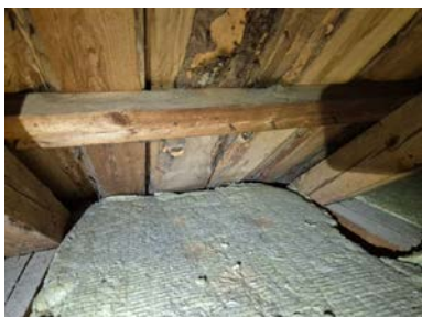
Ikke luft i nedre del av konstruksjon.
