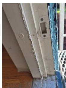
Slitte tettelister på terrassedør mot garasje.
