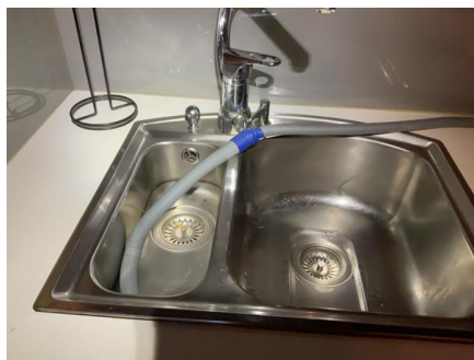
Avløpsslange fra benkoppvaskmaskin ligger løst i kjøkkenkum.
