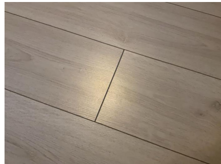
Ujevnt underlag under laminat.
