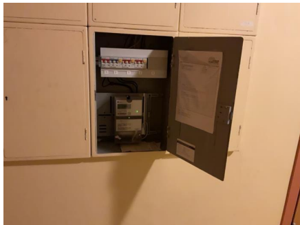
Sikringsskap plassert i felles oppgang.
