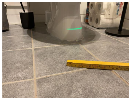
Ujevn høyde på fliser.
