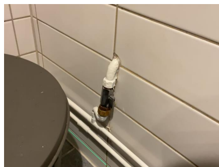
Rørføring i dusjsone.
