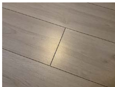
Ujevnt underlag under laminat.
