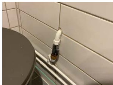
Rørføring i dusjsone.
