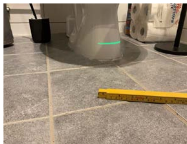
Ujevn høyde på fliser.
