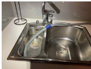
Avløpsslange fra benkoppvaskmaskin ligge løst i kjøkkenkum.
