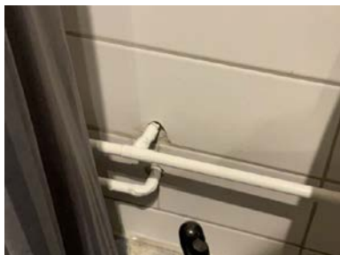
Utettheter rundt rørføring.
