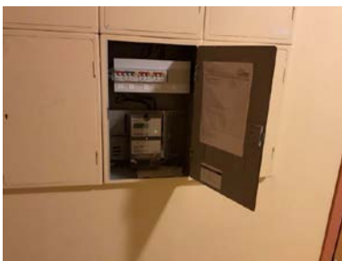
Sikringsskap plassert i felles oppgang.
