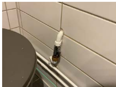
Rørføring i dusjsone.
