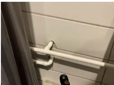
Utettheter rundt rørføring.
