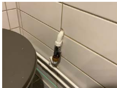
Rørføring i dusjsone.
