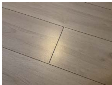
Ujevnt underlag under laminat.
