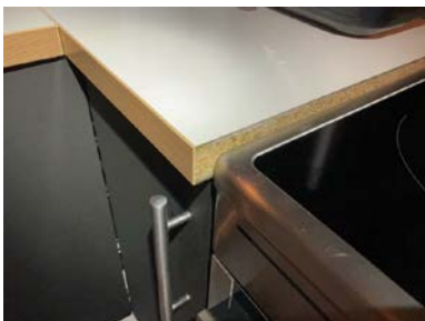
Benkeplate mangler kantlist.
