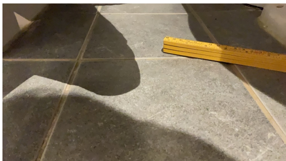
Høydeforskjell på fliser.
