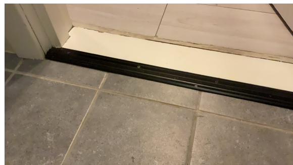
Ingen oppkant ved terskel.
