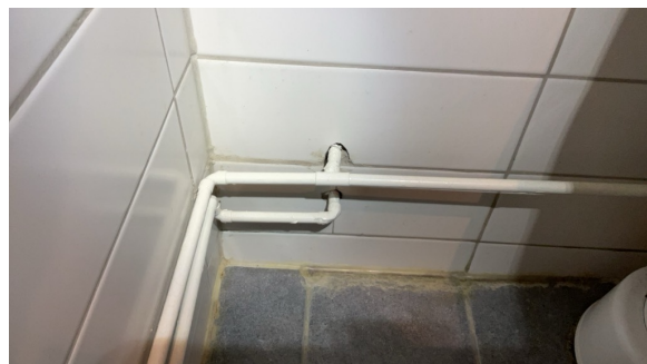
Rørføring i våtsone.
