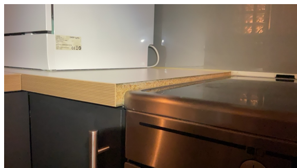
Benkeplate mangler kantlist
