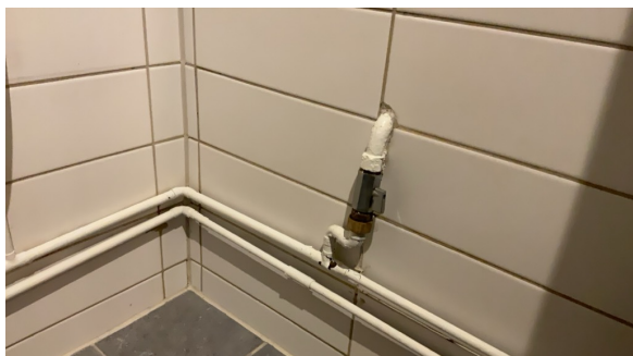
Rørføring i dusjsone.
