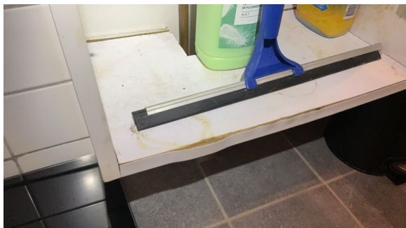
Svelling på innredning.
