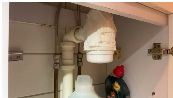
Lekkasje på pakning til vannlås.
