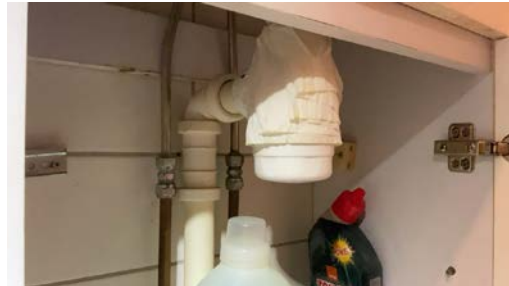
Lekkasje på pakning til vannlås.
