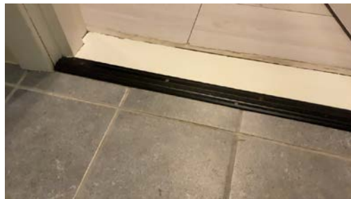
Ingen oppkant ved terskel.
