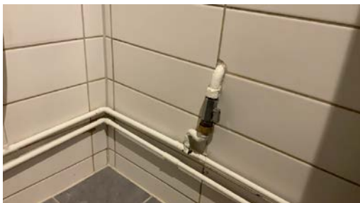
Rørføring i dusjsone.
