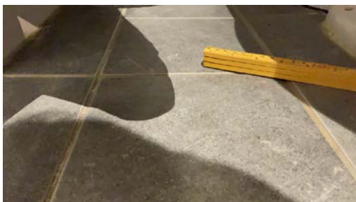
Høydeforskjell på fliser.
