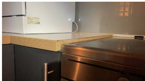
Benkeplate mangler kantlist
