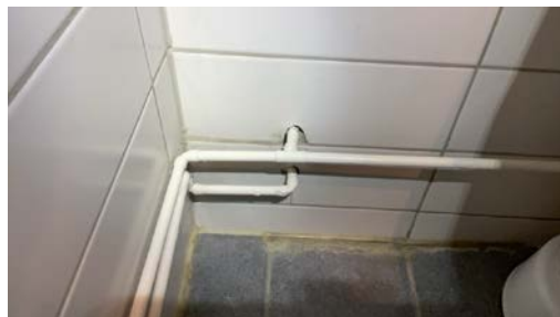
Rørføring i våtsone.
