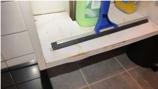
Svelling på innredning.
