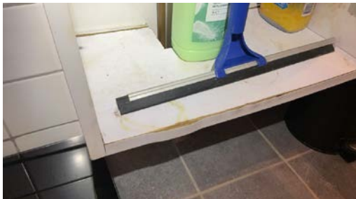
Svelling på innredning.
