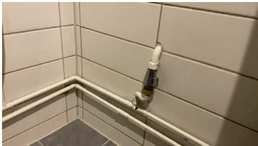
Rørføring i dusjsone.
