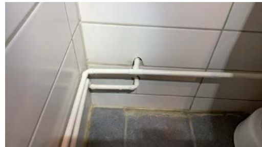
Rørføring i våtsone.
