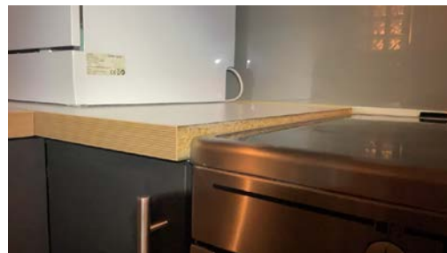
Benkeplate mangler kantlist
