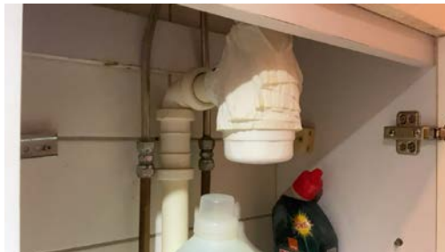
Lekkasje på pakning til vannlås.
