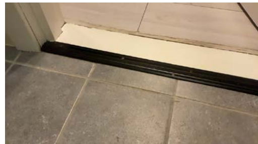
Ingen oppkant ved terskel.
