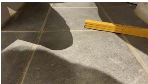
Høydeforskjell på fliser.
