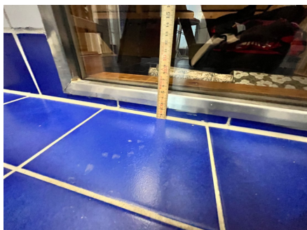
Oppkant under dør til badstue
