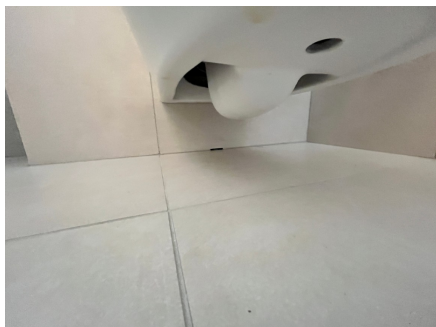
Drensåpning under innbygget vannsisterne på toalett
