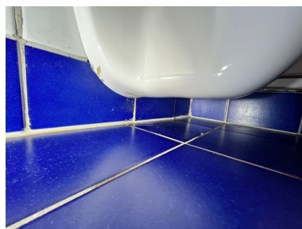
Ingen dreksåpning under toalettet.
