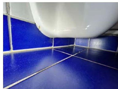
Ingen dreneringsåpning under toalettet.
