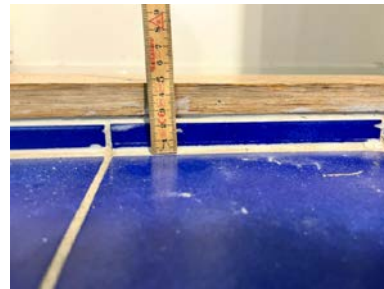
Oppkant under dør til badet
