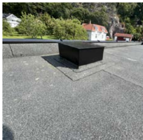
Gjennomføring i tak etter tidligere pipe.
