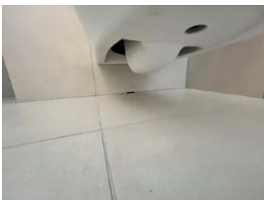
Drensåpning under innbygget vannsisterne på toalett
