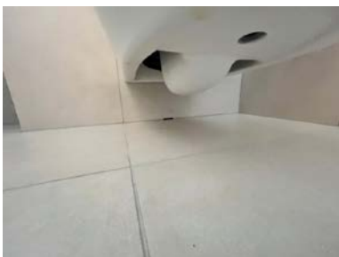
Drensåpning under innbygget vannsisterne på toalett
