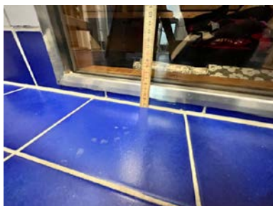
Oppkant under dør til badstue
