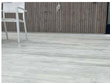
Ulik avstand fra gulv til underkant av kledning, skjevheter på gulvet
