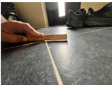
Hakk på flis og ujevn høyde.
