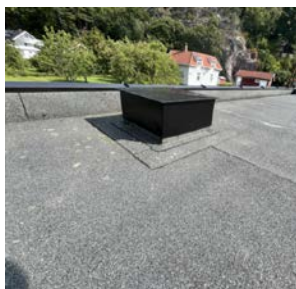
Gjennomføring i tak etter tidligere pipe.
