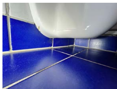
Ingen drengåpning under toalettet.
