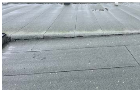
Område der det er risiko for at sammenføyningen kan løsne.
