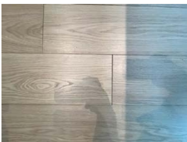
Åpning i skjøt laminat.
