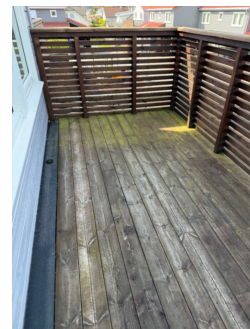
Balkong 2 etasje. Normalt vedlikehold må påregnes.
