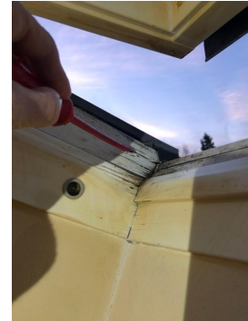
Bilde av råteskade på takvinduet
