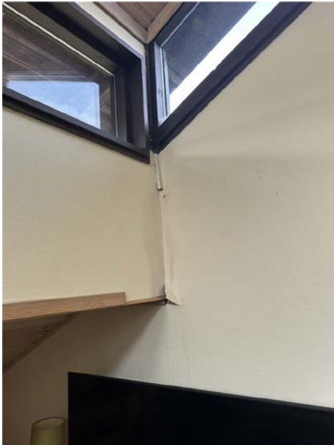
Bildet viser gamle fuktmerker i hjørnet under vinduene. det var helt tørt ved befaring.
