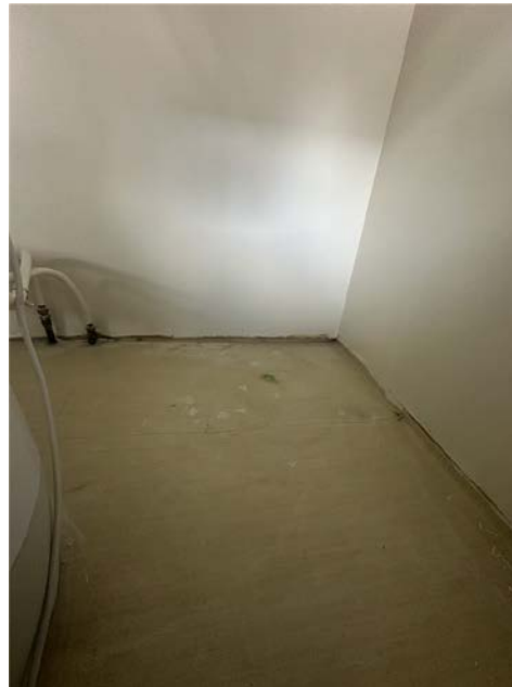
Bildet viser vaskeromsgulv ved varmtvannsbereder. Det er svikt i undergulvet for gulvbelegget. Gulvbelegget er fra byggeår.
