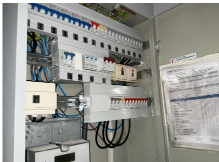
Hybel: Automatsikringer i sikringsskap plassert i vindfang.
