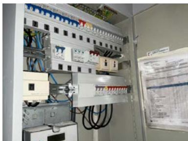
Hybel: Automatsikringer i sikringsskap plassert i vindfang.
