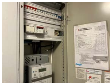
Hoveddel: Automatsikringer i sikringsskap plassert i entré/gang.
