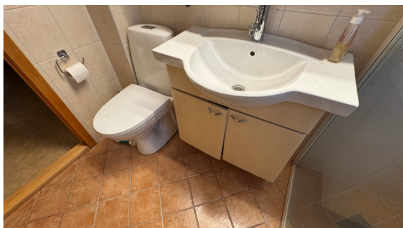
Skapfronter er løs.
