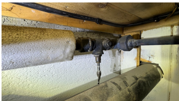
Hovedstoppekran av eldre dato uten kuleventil.
