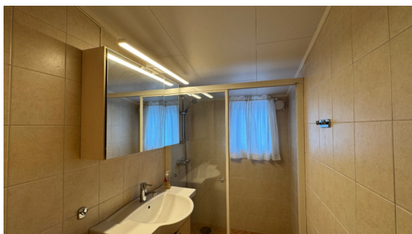
Det er vindu i dusjsonen.
