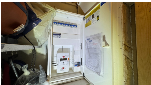
Kontroll av el-skap og kursfortegnelse.
