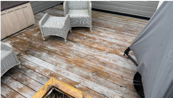
Terrassedekket er noe værslitt.
