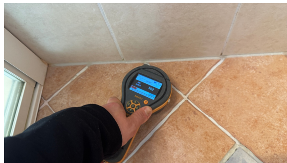
Det er målt forhøyede fuktverdier i gulvet i dusjsonen.
