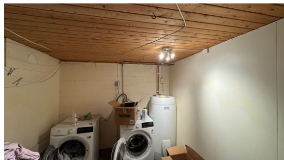
Det er ikke etablert membran/tettesjikt på vegger.
