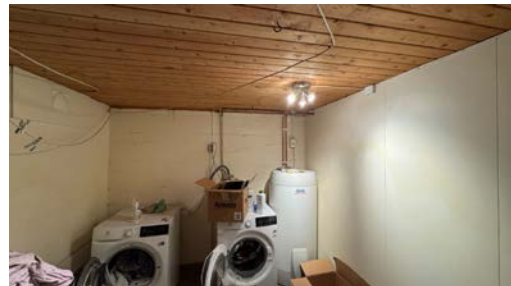
Det er ikke etablert membran/tettesjikt på vegger.
