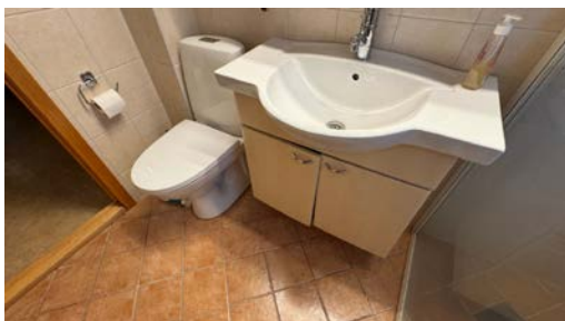
Skapfronter er løse.
