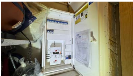
Kontroll av el-skap og kursfortegnelse.
