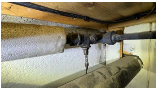
Hovedstoppekran av eldre dato uten kuleventil.
