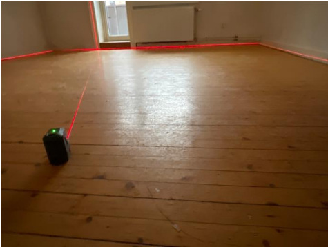
Nivellering stue, avvik ca. 15-30 mm
